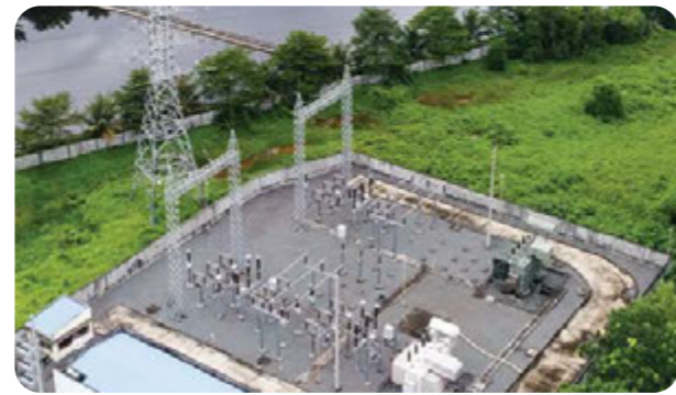
Hệ thống cung cấp điện
