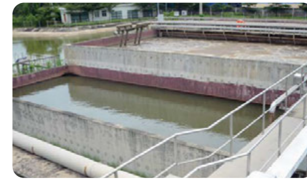
Hệ thống xử lý nước thải khu đa ngành
